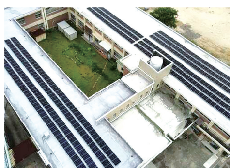
入野小学校設置の太陽光発電設備
