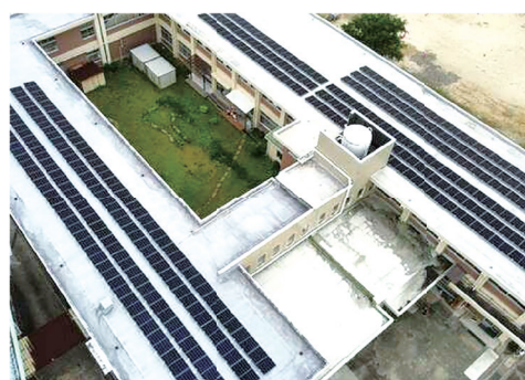
入野小学校設置の太陽光発電設備
