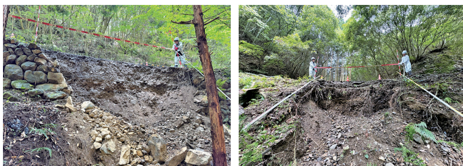
町道矢野川線の被災状況
