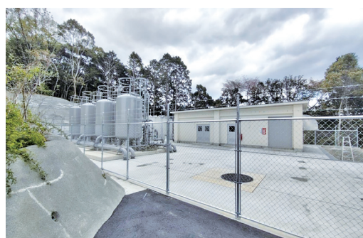
上川口浄水場 急速ろ過施設
