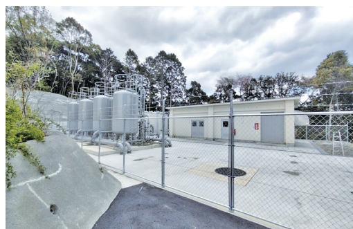
上川口浄水場 急速ろ過施設
