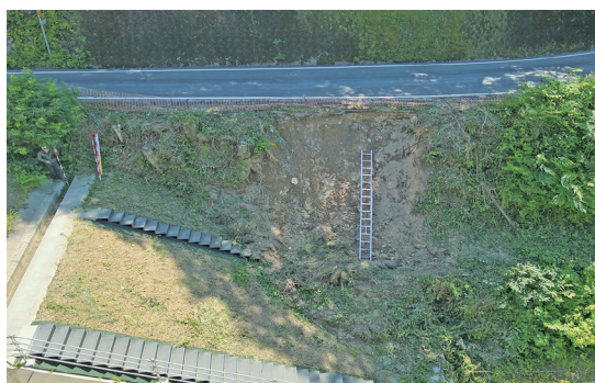
災害現場(町道荷稻鈴線)
