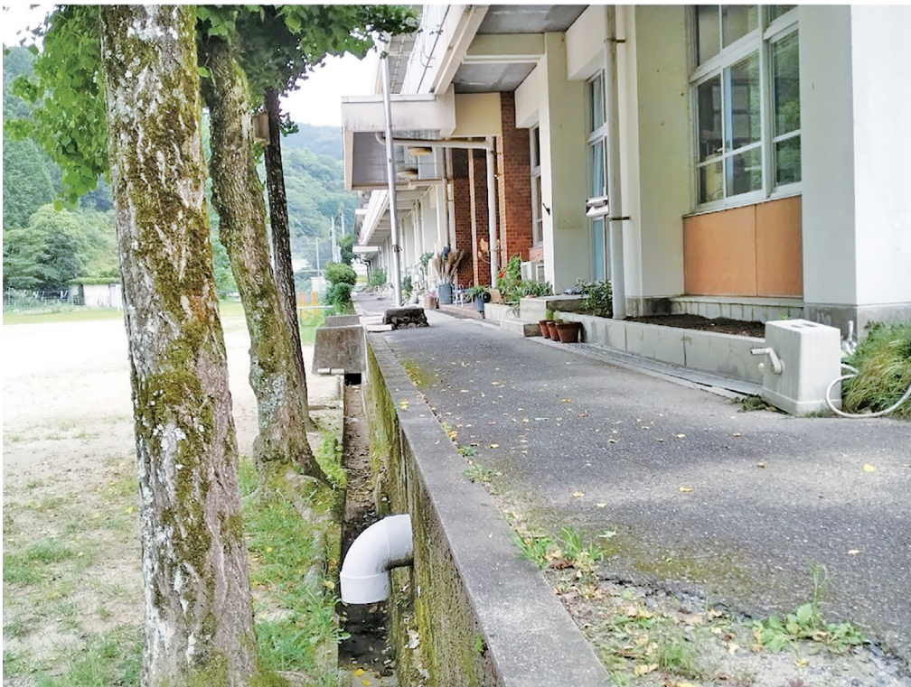
拳ノ川小学校の通路幅 1.1m～1.7m 高さ 0.85m 危険
