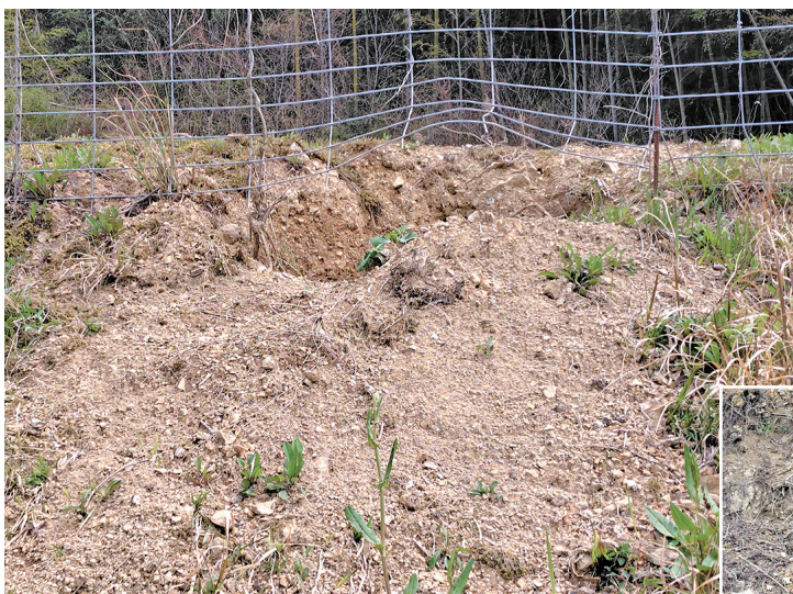
被害を受けた防護柵（上と右）
