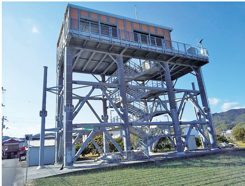
スロープ設置が待たれる避難タワー（新町）
