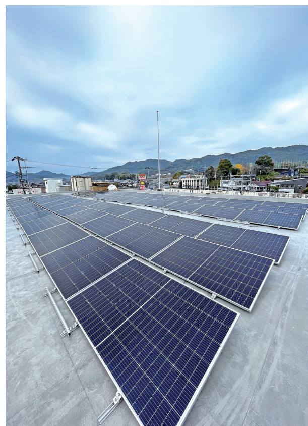
保健福祉センター屋根上パネル
