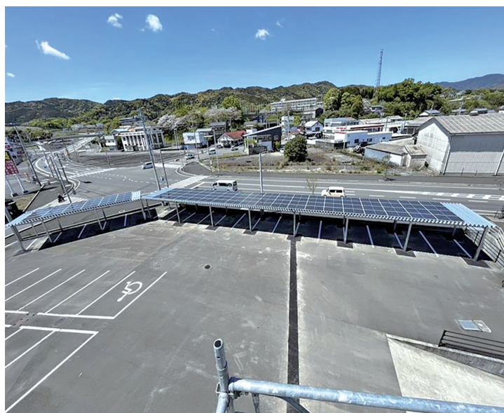
保健福祉センターカーポートパネル
