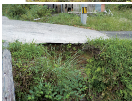
蜷川地区の農道路肩崩落（令和6年6月下旬）
