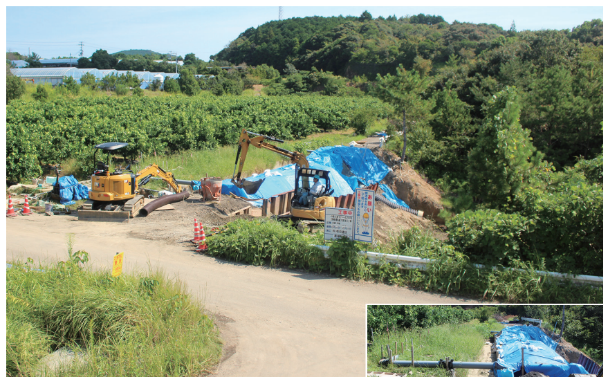
農道と水道管の被災現場。 右は、応急措置中の迂回水道管 （令和6年10月1日、ヤモウジ団地）
