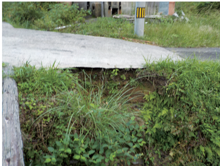
蛸川地区の農道路肩崩落 （令和6年6月下旬）
