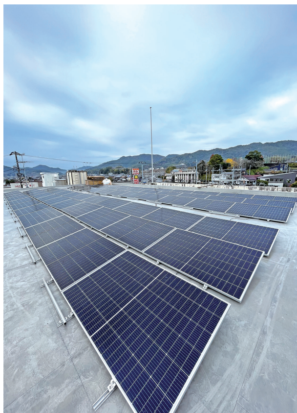
保健福祉センター屋根上パネル
