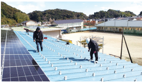
「くろしおエナジー株式会社」関連で設置の進む太陽光発電事業の一例 (上：ビオスおおがた、下：佐賀小学校。共に令和5年度事業で設置済み)
