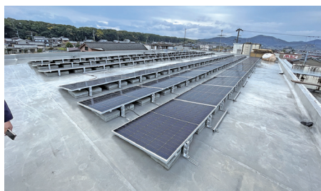
保健福祉センター屋上の太陽光パネル
