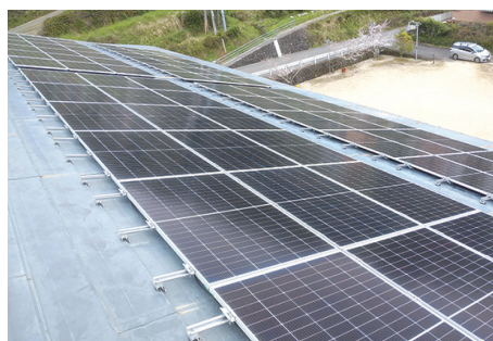
湊川ふれあいセンター 屋上に設置の太陽光パ ネル（令和6年3月）
