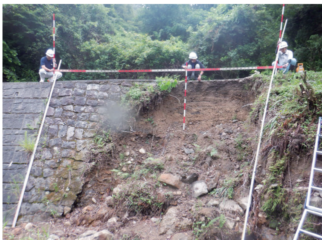
町道水無瀬線の路肩崩落現場 (馬荷)
