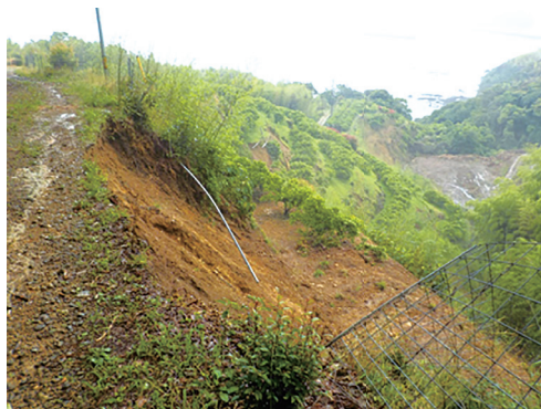
通称パイロットの農道路肩崩落現場 (大和田)
