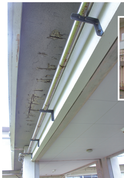
骨材の腐食による傷みが多く見られる軒天井の1例（3月下旬）
