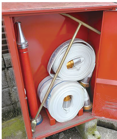
ホース格納庫の1例。消火栓キーハンドルや消防ホース、管槍が収納されている
