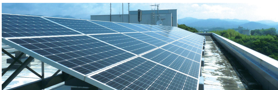
庁舎屋上に設置のソーラーパネル
