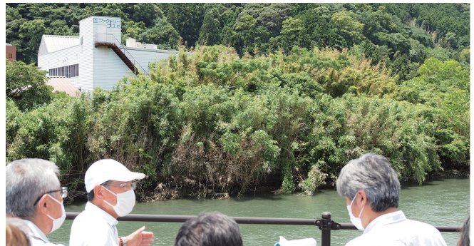
ここ数年の台風等の影響で右岸の浸食が続く。上流の堤防も一部崩壊している。現地調査を要望(町分)
