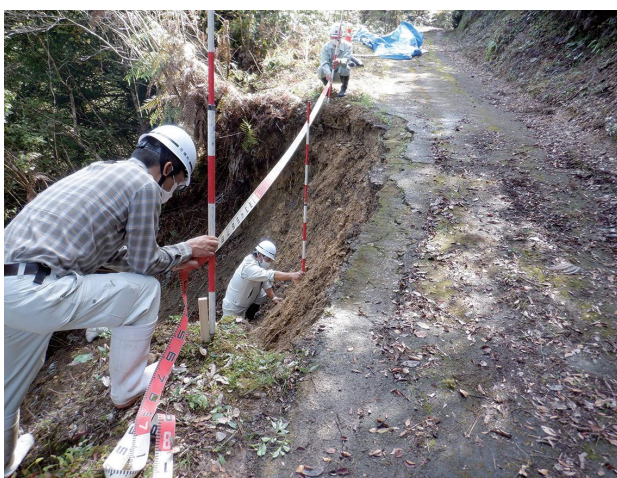
町道橘川馬荷線の道路災害
