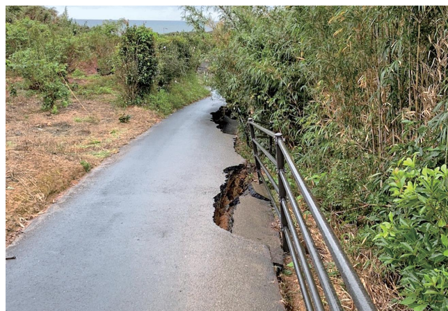
9月の豪雨で一部崩落した避難道(出口地区)
