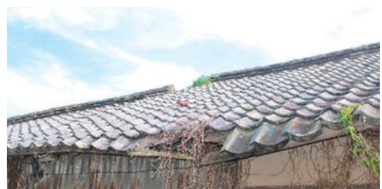
屋根が傷み始めた空き家
