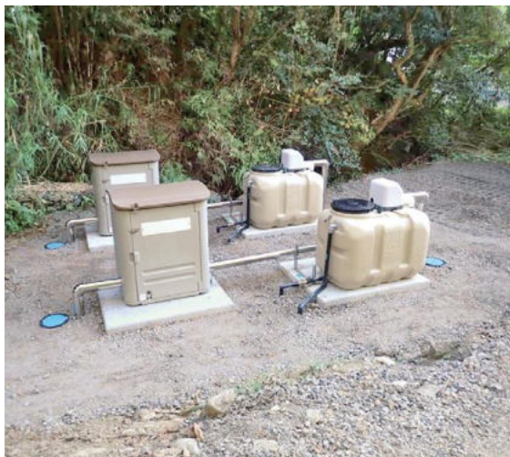
須賀留地区の給水設備
