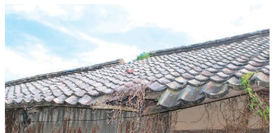
屋根が傷み始めた空き家
