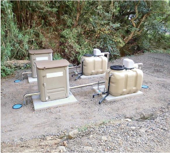
須賀留地区の給水設備
