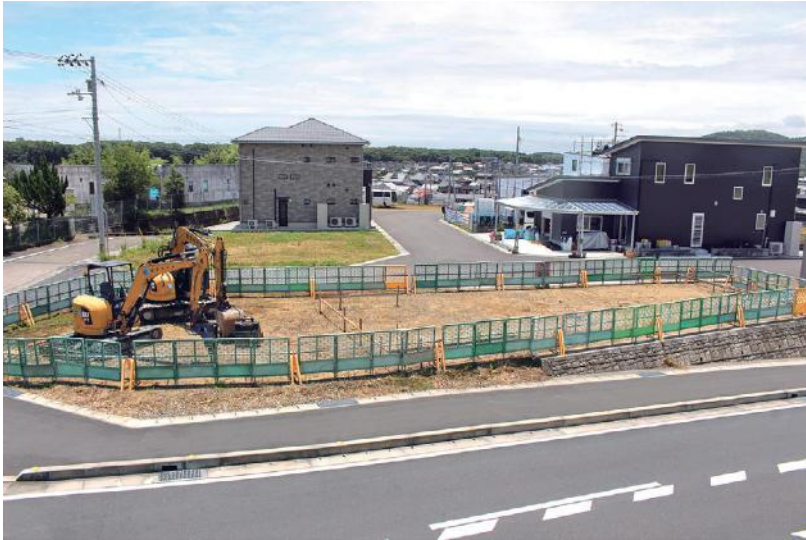
耐震性貯水槽が設置される城山団地
