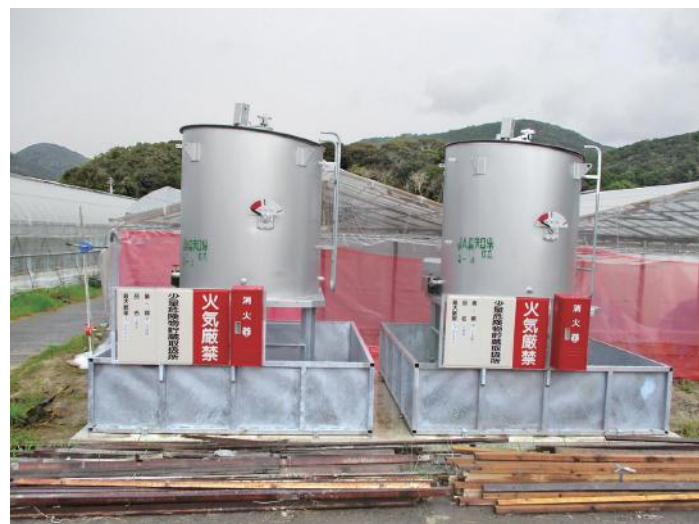
津波浸水区域内のハウスに設置の 耐震性燃料タンク
