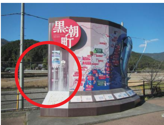
老朽化した観光掲示板（特に丸枠内の傷みが激しい）
