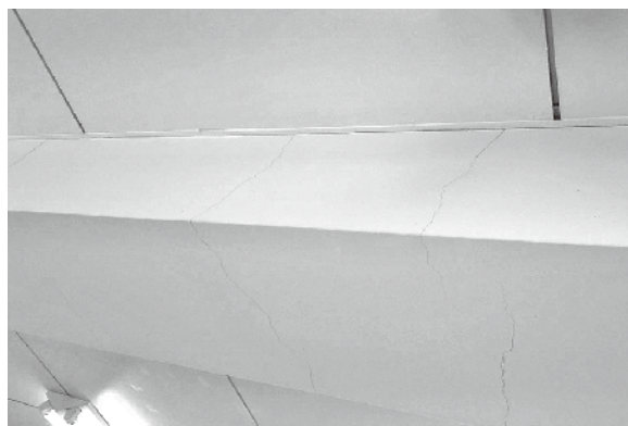
天井の部分にひび割れがみられるくじらルーム
