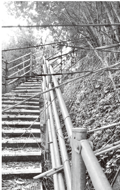
倒れた竹が通行を妨げている避難階段（右）
