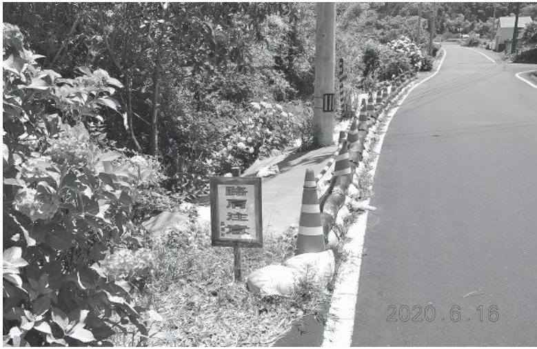
災害復旧工事を待つ 洪水崩壊の危険箇所（町道馬地中角線）
