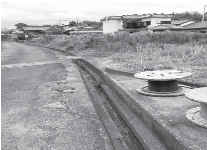
修繕が待たれる蓋のない側溝
