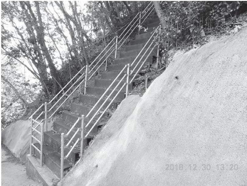
改修すべき避難道 (有井川)
