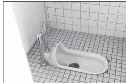
改修が待たれるトイレ
