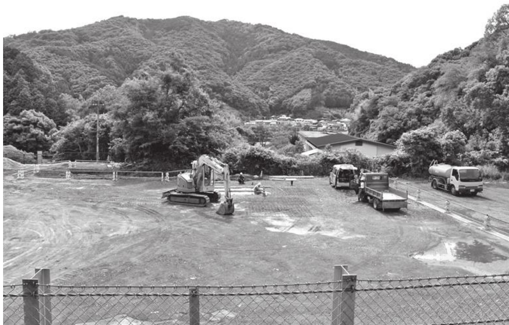
工事が進む佐賀保育所（仮称）中央奥には伊与喜小学校や集落が見える（6月下旬、東側より望む）
