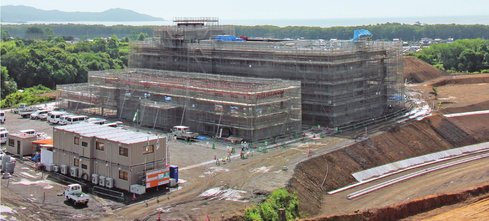
梅雨空の下で進む新庁舎建設工事 後方には入野松原や海、その左手には井の岬が望める (平成29年6月23日)
