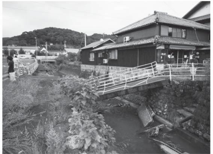
為の川に架かるミノコシ橋の崩落 (上川口浦地区)
