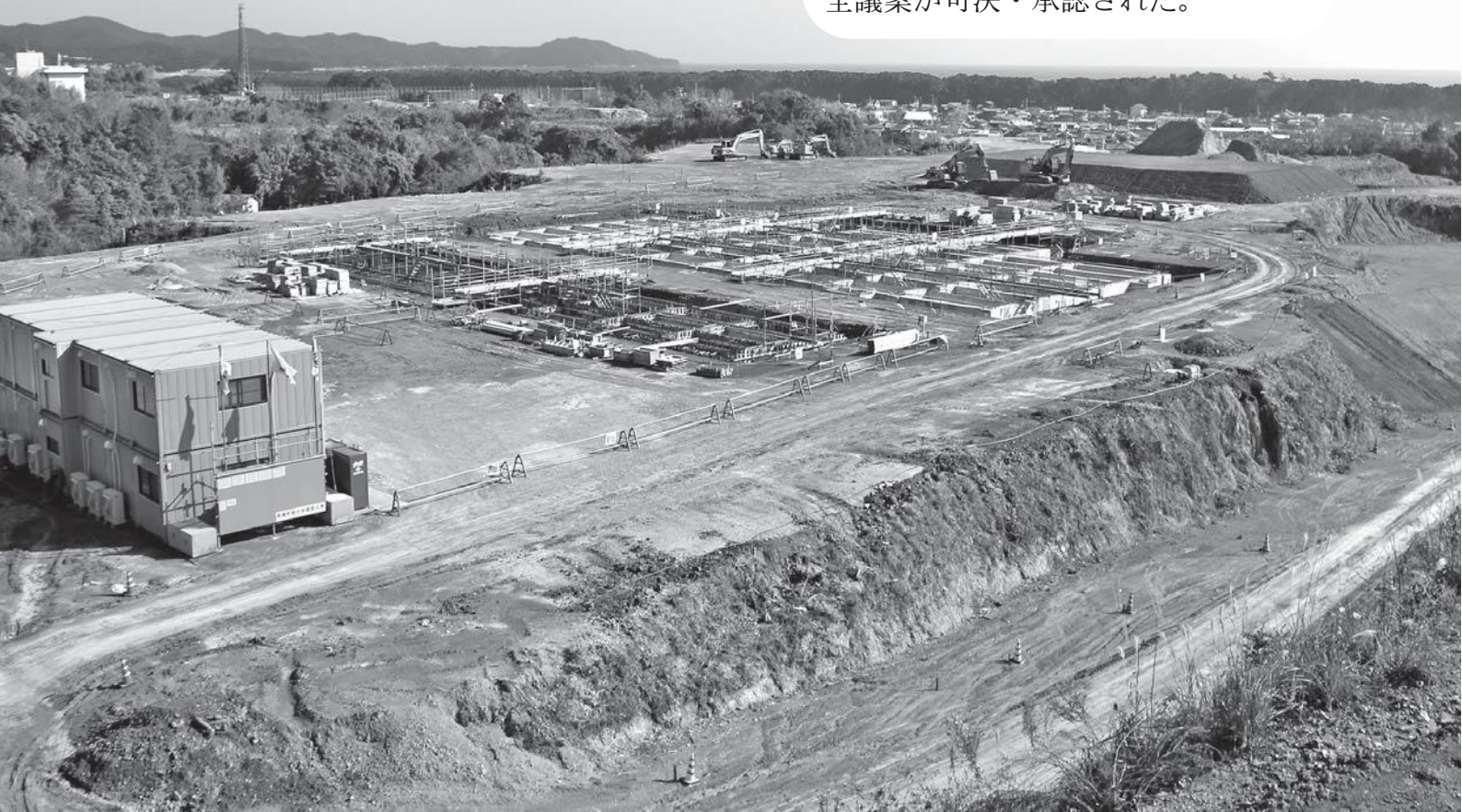
新庁舎建設工事現場（中央部近が予定地）の現況。中央奥側には井の岬が望める（1月4日撮影）
