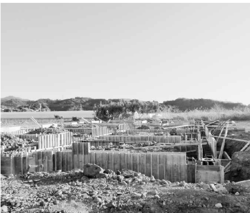
地域産品加工施設(黒潮工房(仮))の工事現場 (入野早咲地区)
