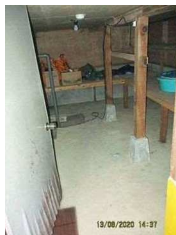
内部仕上げ 機能性に問題あり 判定C
