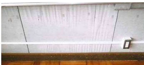
内部仕上げ 劣化がみられるが機能性に問題なし 判定B
