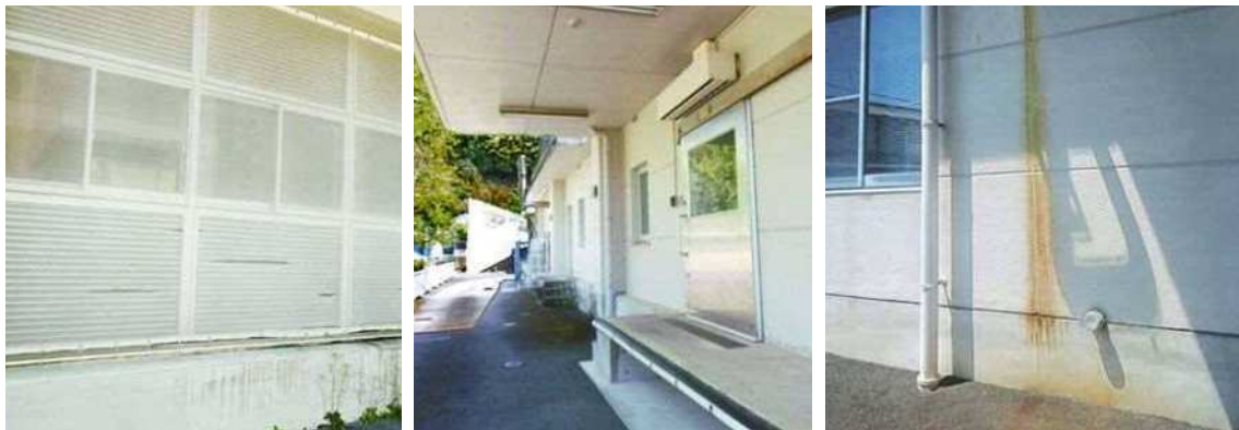
外壁 劣化がみられるが機能性に問題なし 判定B
