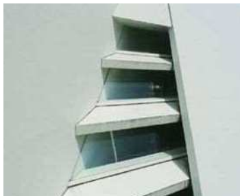
外壁 劣化がみられるが機能性に問題なし 判定B
