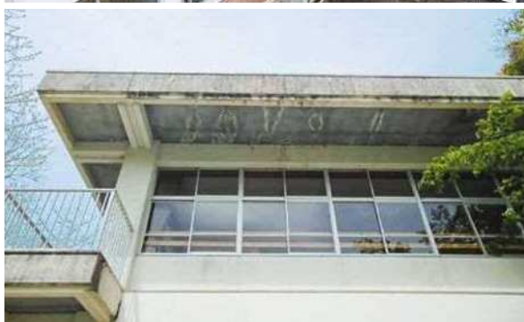
外壁 劣化がみられるが機能性に問題なし 判定B
