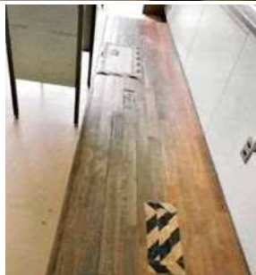
内部仕上げ 劣化がみられるが機能性に問題なし 判定B
