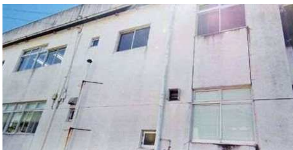
外壁 劣化がみられるが機能性に問題なし 判定B
