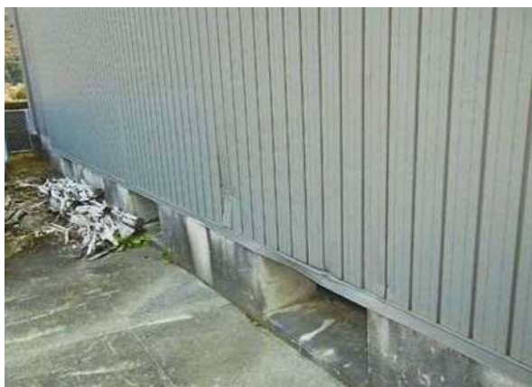
外壁 劣化がみられるが機能性に問題なし 判定B
