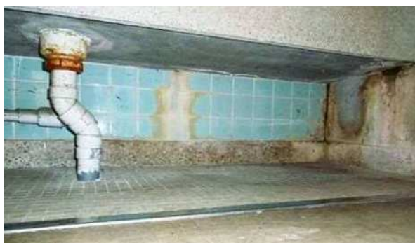
内部仕上げ 機能性に問題あり 判定C
