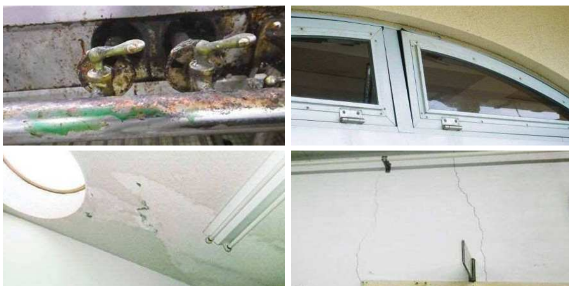
内部仕上げ 機能性に問題あり 判定C
