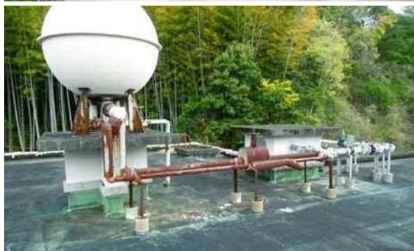
屋根・屋上 防水シートの破れ複数 判定C
