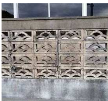
外壁 ひび、剥がれが激しい 判定C
