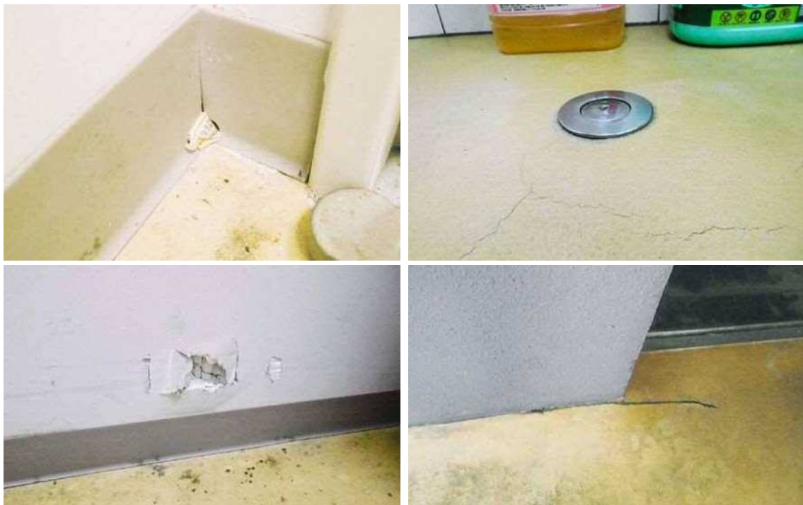
内部仕上げ 機能性に問題あり 判定C
