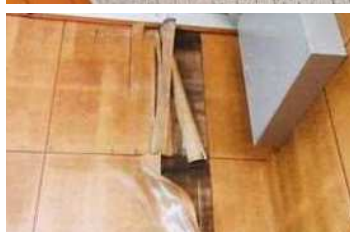
内部仕上げ 機能性に問題あり 判定C
