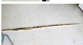
内部仕上げ 機能性に問題あり 判定C
