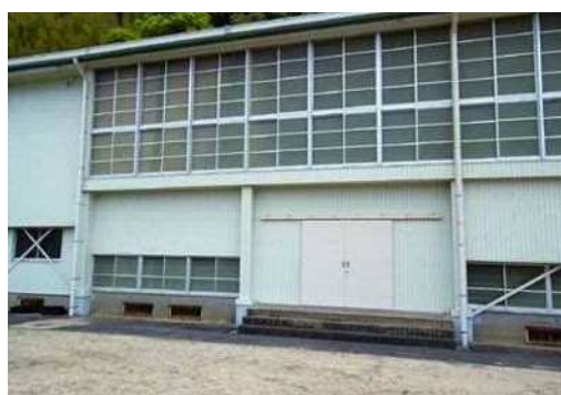
外壁 劣化がみられるが 機能性に問題なし 判定B
