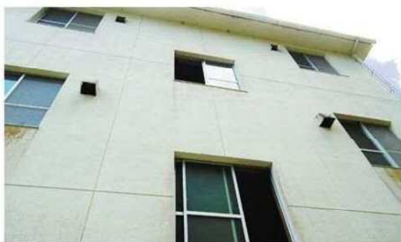
外壁 劣化がみられるが機能性に問題なし 判定C
