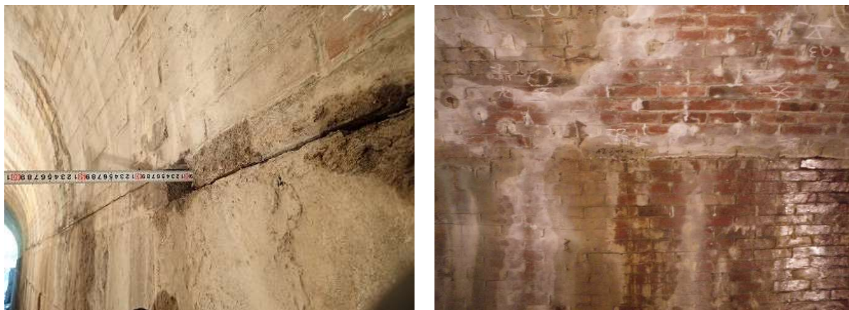
写真 1.2.3 連続する覆工ひび割れ
