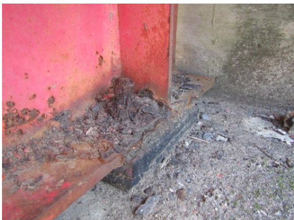
●鋼部材の腐食
