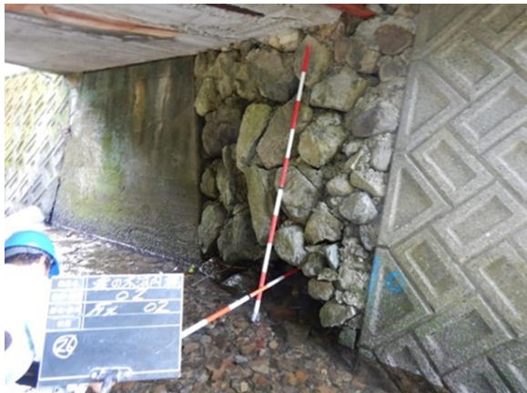
●石積みの抜け
