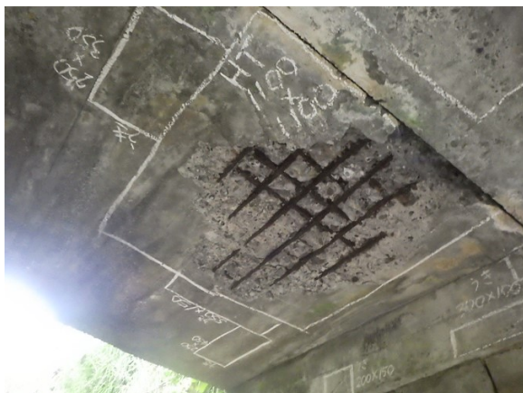
●床版の鉄筋露出
