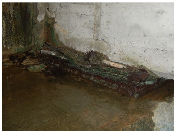
●支承の機能障害
