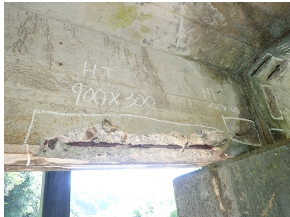
●コンクリートの鉄筋露出
