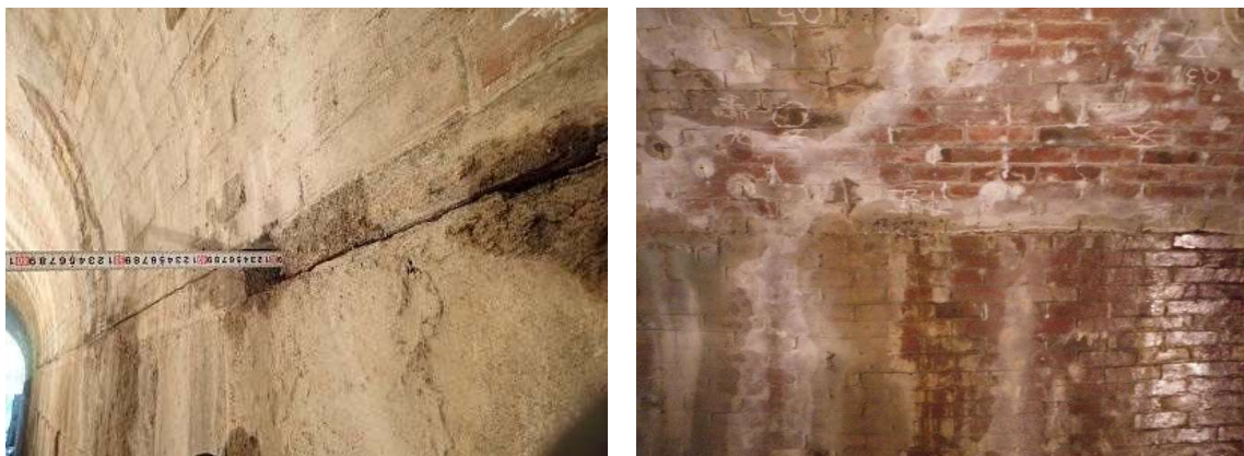
写真 1.2.3 連続する覆工ひび割れ
