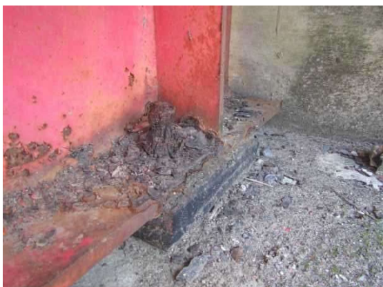
●鋼部材の腐食
