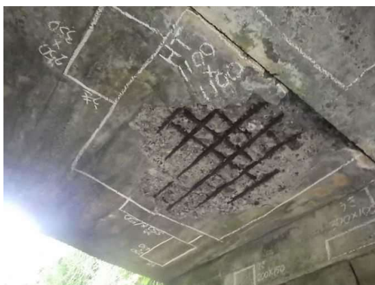
●床版の鉄筋露出
