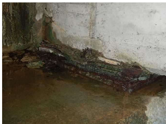
●支承の機能障害
