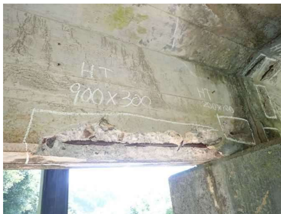
●コンクリートの鉄筋露出
