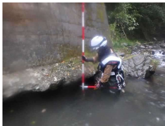
●下部工の洗掘
