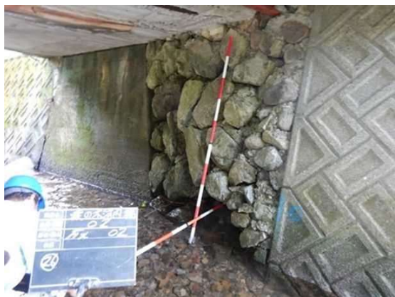
●石積みの抜け
