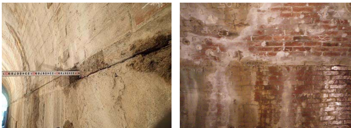
写真 1.2.3 連続する覆工ひび割れ
