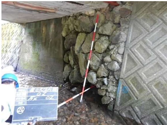
●石積みの抜け
