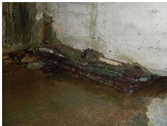
●支承の機能障害
