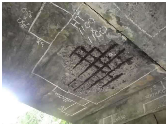
●床版の鉄筋露出
