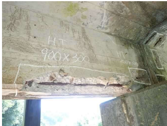
●コンクリートの鉄筋露出
