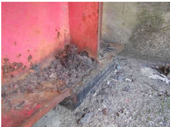
●鋼部材の腐食
