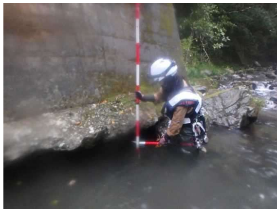
●下部工の洗掘
