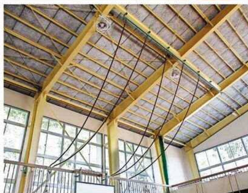
内部仕上げ 機能性に問題あり 判定C
