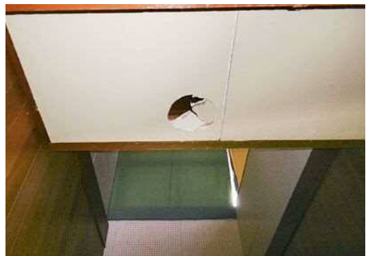
内部仕上げ 劣化がみられるが 機能性に問題なし 判定B
