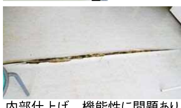
内部仕上げ 機能性に問題あり 判定C
