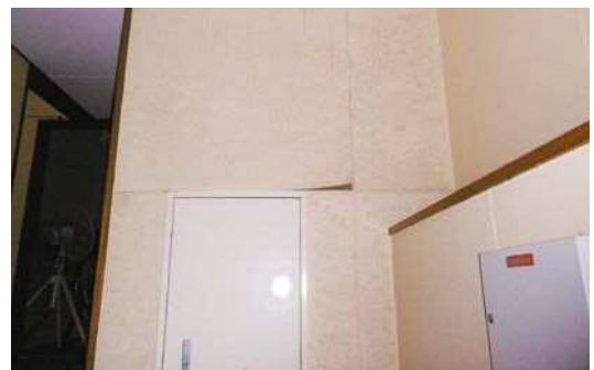
内部仕上げ 劣化がみられるが機能性に問題なし 判定B
