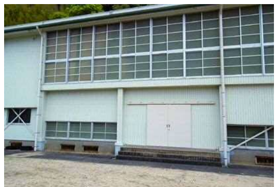
外壁 劣化がみられるが 機能性に問題なし 判定B
