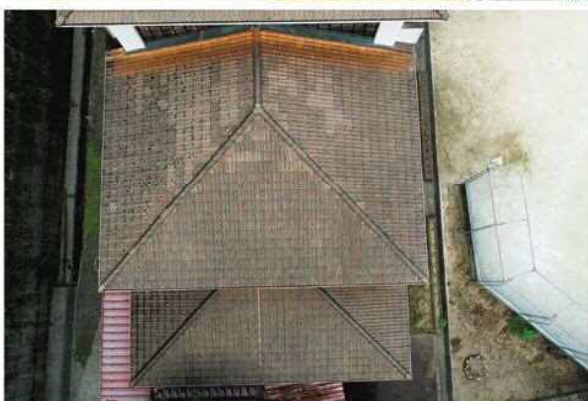
屋根・屋上 劣化がみられるが機能性に問題なし 判定C
