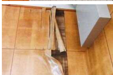
内部仕上げ 問題あり 機能性に判定C
