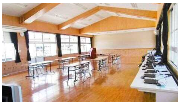
内部仕上げ 劣化がみられるが機能性に問題なし 判定B
