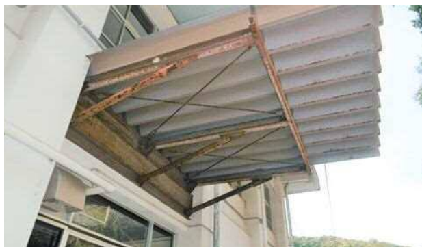
外壁 劣化がみられるが機能性に問題なし 判定B
