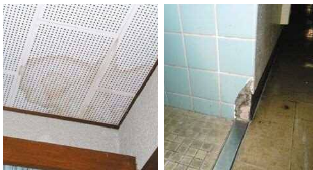
内部仕上げ 劣化がみられるが機能性に問題なし 判定B
