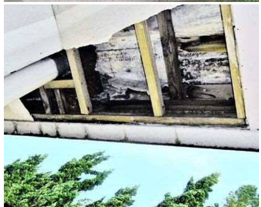
屋根・屋上 屋根の内側が激しく劣化 判定C
