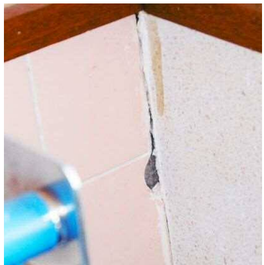
内部仕上げ 劣化がみられるが 機能性に問題なし 判定B
