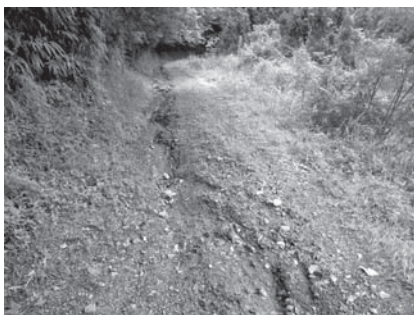
補修が必要な状況の林道の一例
