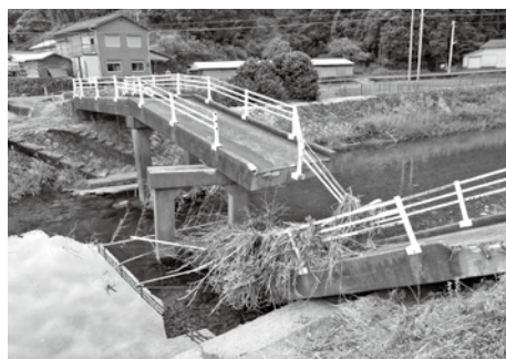
復旧が待たれる法寿院橋（有井川）
