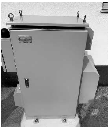
寄贈された発電機
