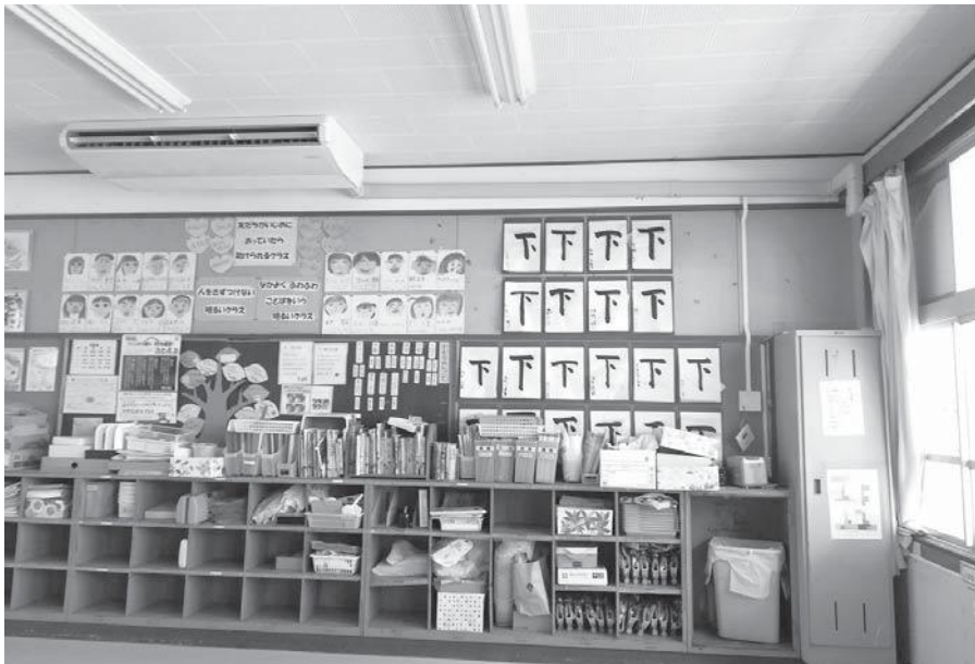
入野小学校に設置されたエアコン
