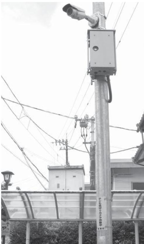
入野駅に設置された防犯カメラ
