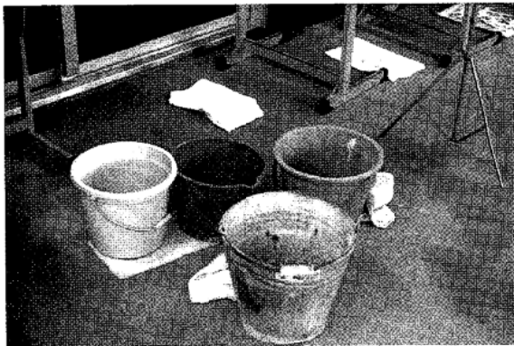
佐賀中音楽室雨漏り用のバケツ
